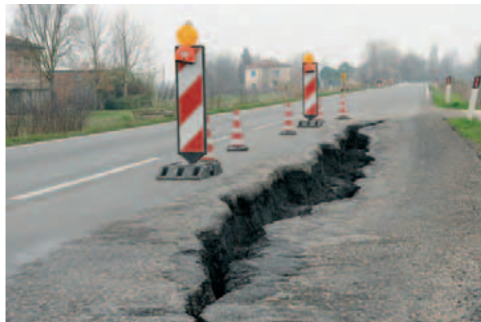
Strada statale 16 - Reale in località Villa Pianta: una frana lunga una decina di metri, dimenticata dall'Anas da un semestre, è causa di disagio e di continui rischi di incidenti stradali. Una conferma del dissesto di una delle strade più trafficate d'Italia.
